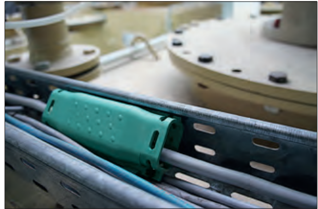
Gel-Kabelgarnitur Relifix V als Kabelverbindung.
