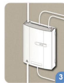
Beispiel 3: LWL-Steigleitung (Riser Cable) über den PBA48 geführt
