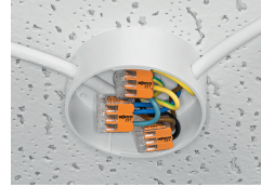
Leuchtenverteilung in Deckenbaldachin
