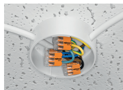
Leuchtenverteilung in Deckenbaldachin
